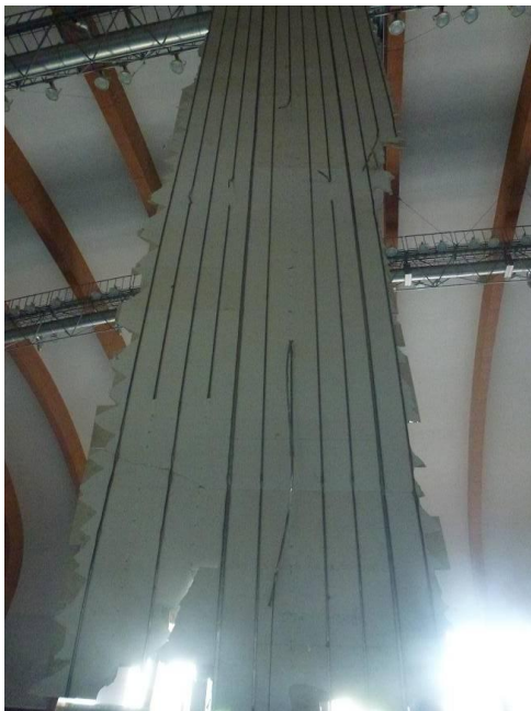
図 1 - 2 脱落した天井材
